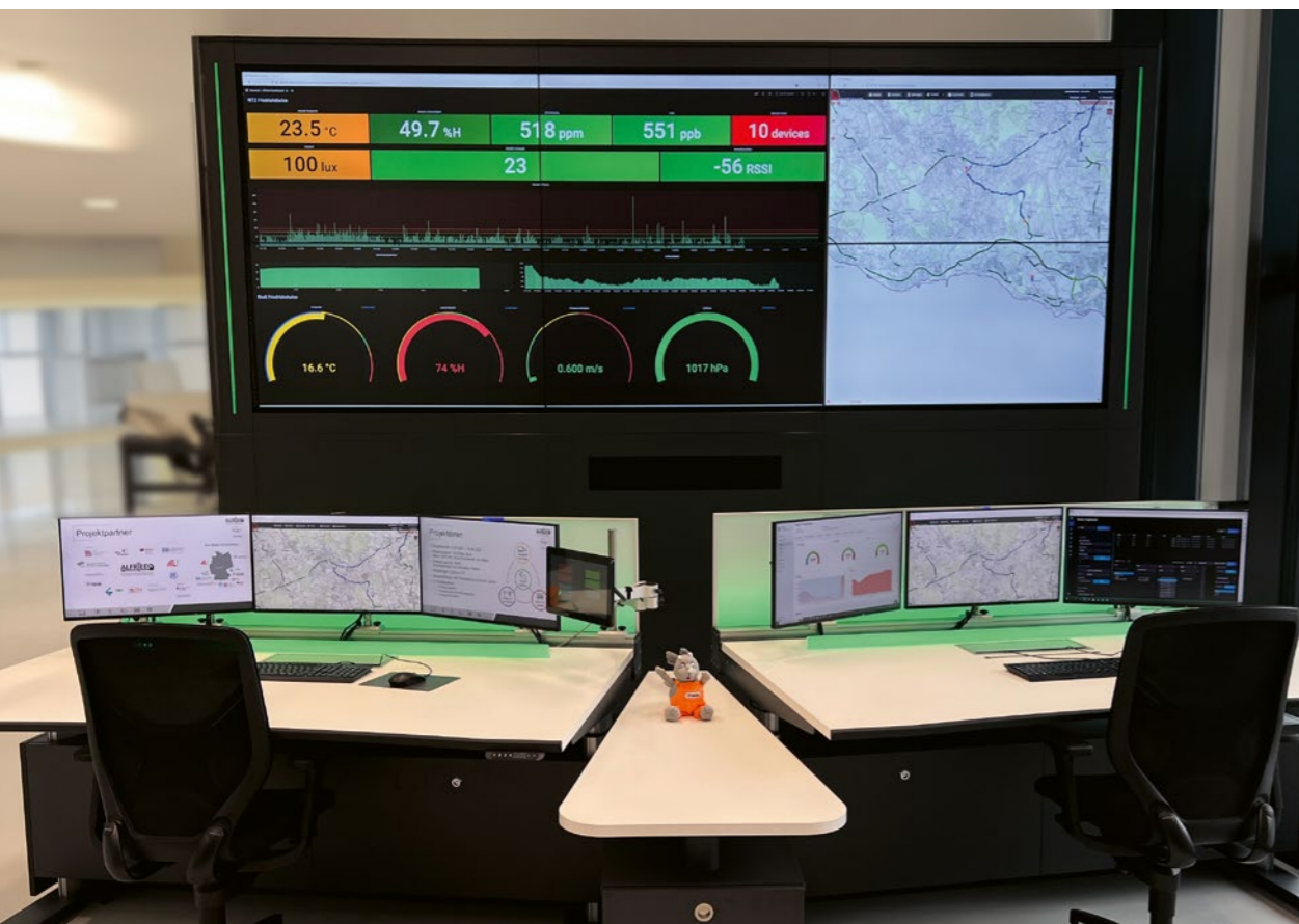
Die Smart-City-Leitstelle: Für die Steuerung und den Zugriff auf mehrere Computer kommt ein IHSE KVM-System zum Einsatz.
