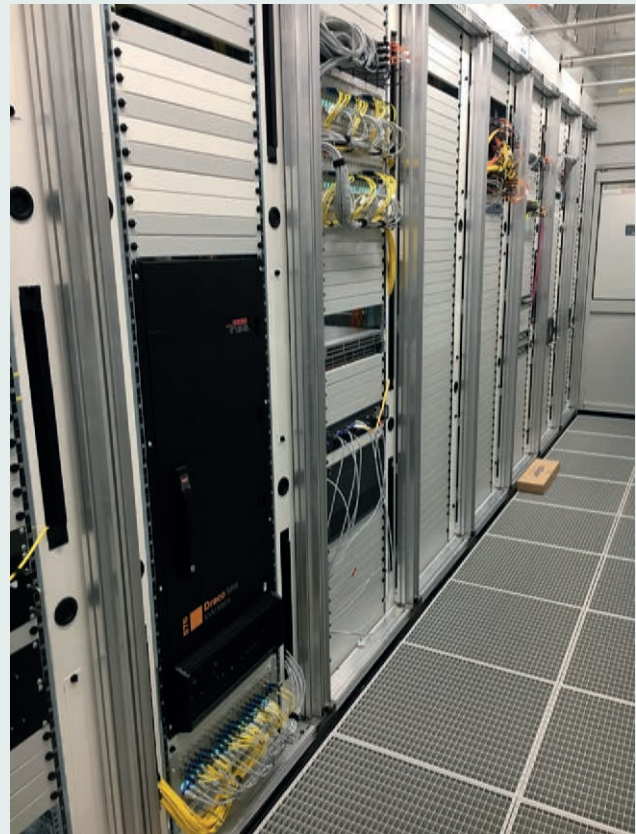
Serverschränke mit 576-Port Draco tera enterprise und ausgelagerten Rechnern im zentralen Media Data Center
