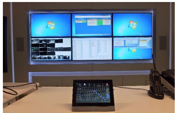
Videowand und Touchpanel in der Leitstelle
