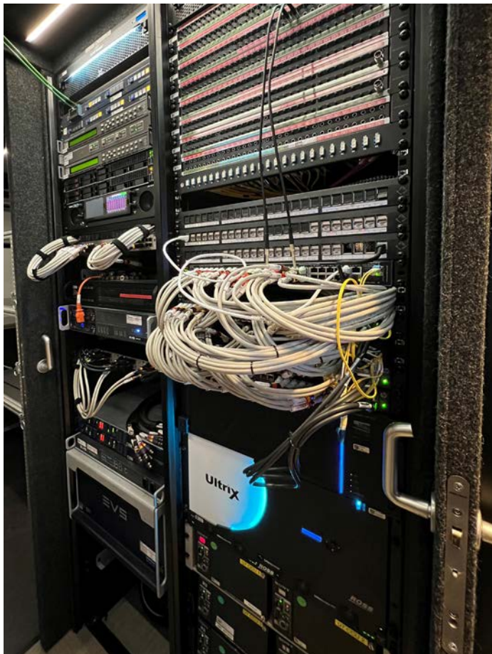
Auslagerung der Server und Quellgeräte im zentralen Geräteraum
