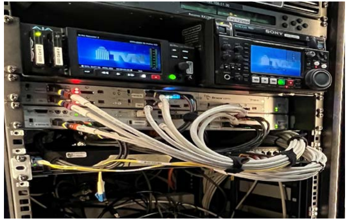
Platzsparende Unterbringung des KVM-Systems im zentralen Geräteraum
